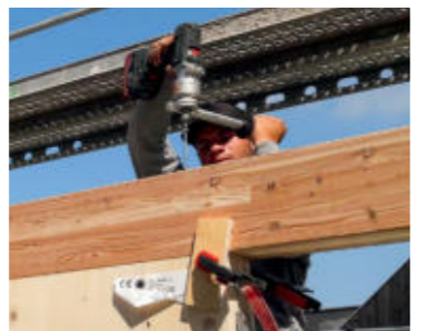
16 Dann stellen lange Schrauben, die von oben her eingedreht werden, die dauerhaft bündige Position der Querpfette sicher.
