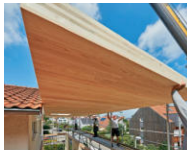
21 Millimeterarbeit am Dachüberstand. Hier auch schön zu sehen, dass die Unterseite querverlegtes Lärchenholz zeigt.
