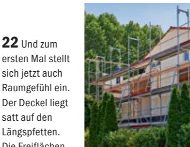
22 Und zum ersten Mal stellt sich jetzt auch Raumgefühl ein. Der Deckel liegt satt auf den Längspfetten. Die Freiflächen füllen später bodenstehende Fenster.
